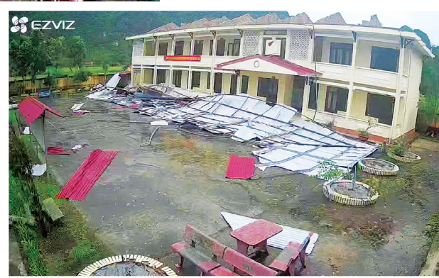
Trường Tiểu học Thống Nhất, xã Bình Long (Võ Nhai) bị tốc mái hoàn toàn.
