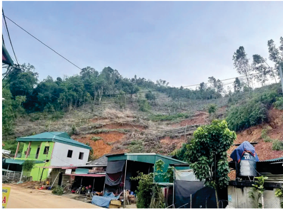
Trên đồi phía sau khu dân cư thôn Nà Áng, xã Nam Cường xuất hiện các vết sạt trượt dài sau cơn bão Yagi năm 2024.
