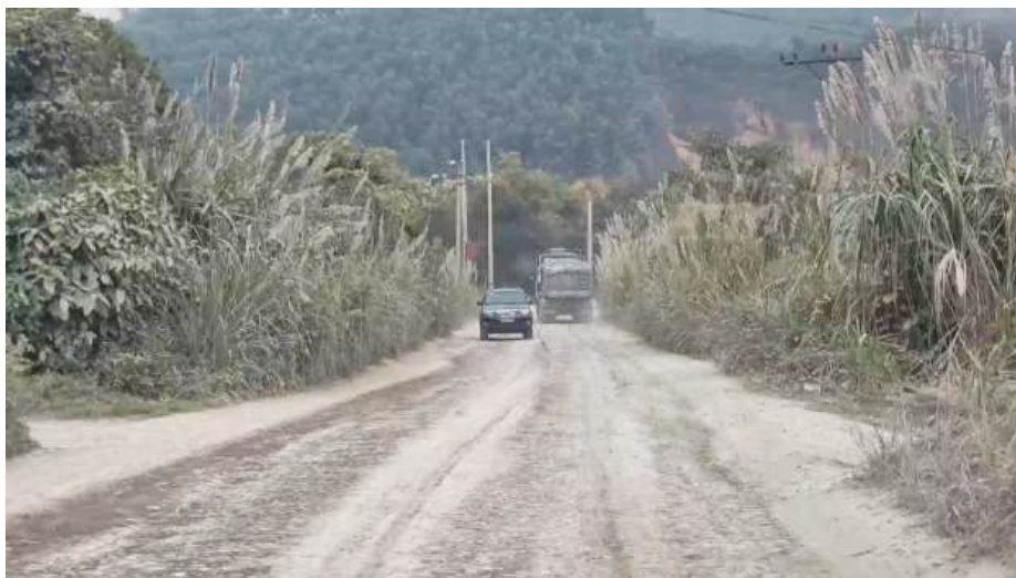
Tuyến đường bị hư hỏng, xuống cấp ở xã Quang Sơn.
